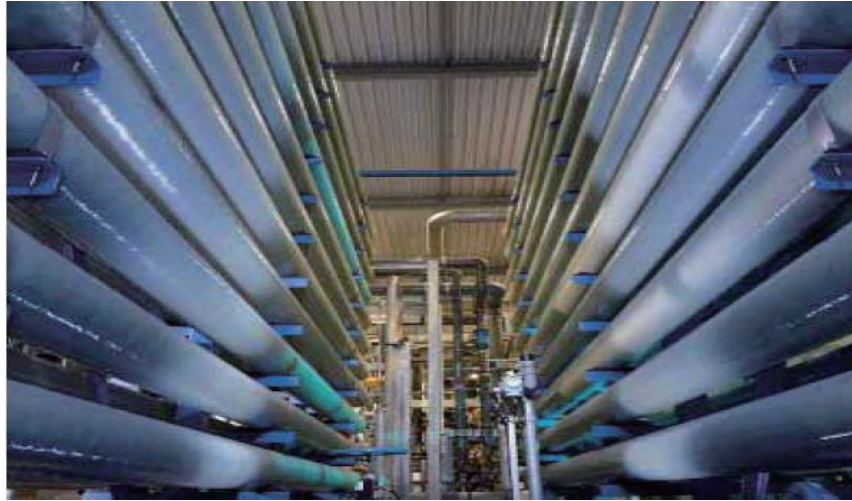
DECO 水处理厂所采用的装有反渗透膜(RO)元件的压力容器 (照片由艾威迪斯(Evides)工业用水公司提供)
