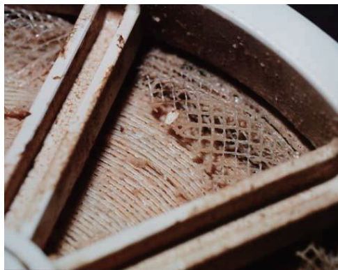
图 9-10 生物污堵所致高压差将流道网格冲出
